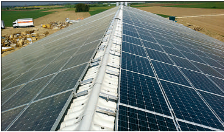
Stalldach mit Solarmodulen: In Kürze soll eine Berieselungsanlage nachgerüstet werden, um die Module sauber und im Sommer kühl zu halten.
